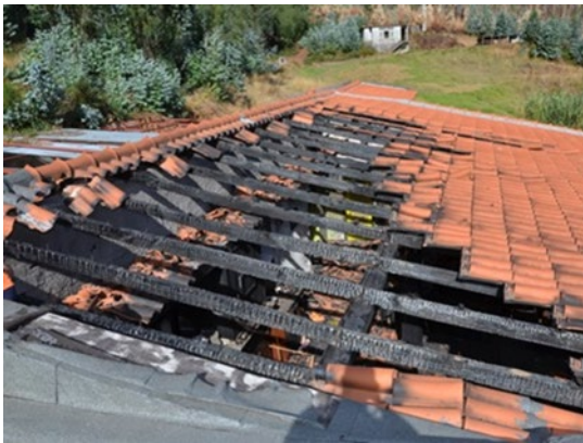
Figura 3: Tetto danneggiato dall'incendio di Funchal (Portogallo) nel 2016 [7]
