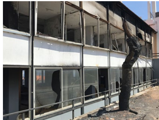
Figura 4: Vetrate rotte in Neos Voutzas-Mati (Grecia, 2018) a causa della combustione di un pino [7]
